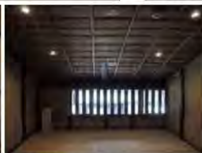
自動火災報知設備、非常用照明
