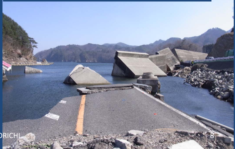
釜石市両国：滑動した防波堤
