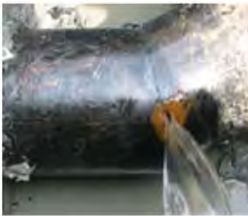
漏水しているパイプライン
